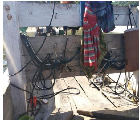
Gambar 2. Kabel Aliran Listrik Kapal
